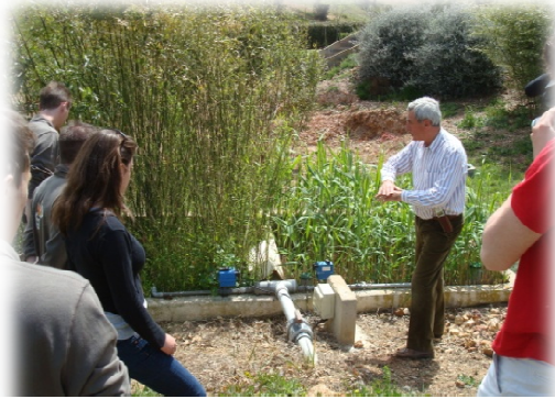
Bac de filtrage
